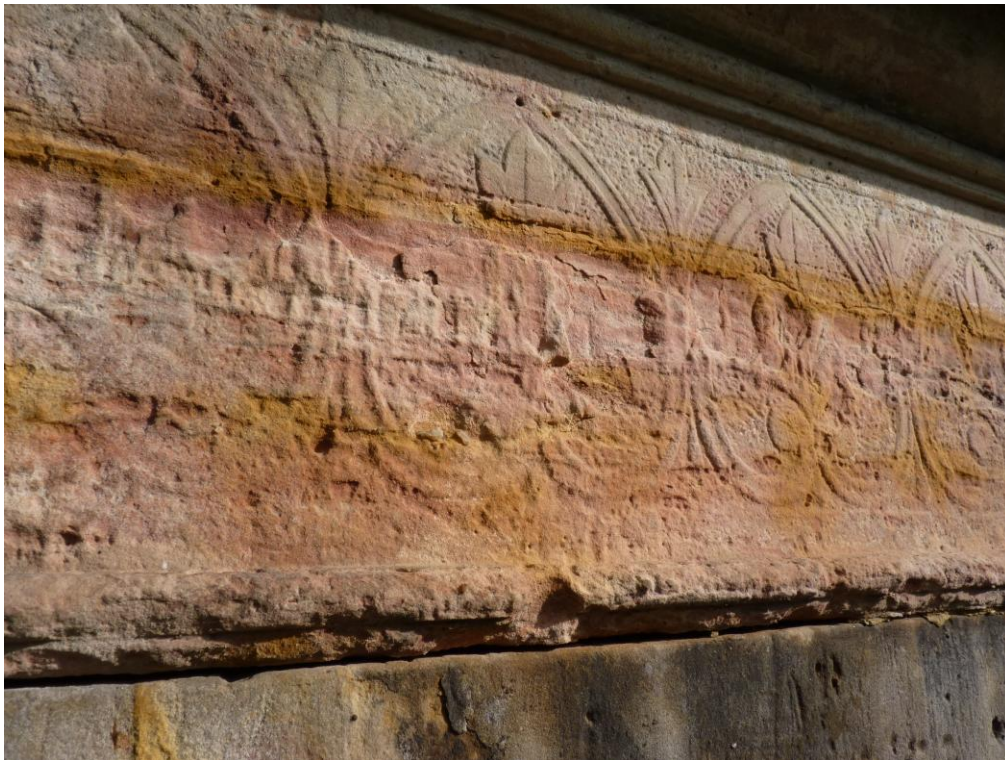
Detail poškození pod krycí římsou vlivem koroze kamene.
